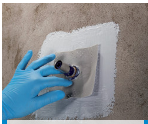
Aanbrengen van een Mapeband PE 120 afdichting voor doorlopende gaten met Mapegum WPS
