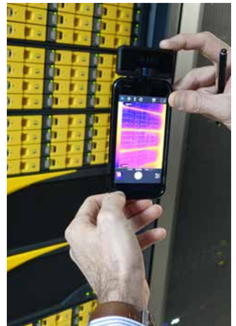
Met steekproeven op de racks wordt de recirculatie van warme lucht aan het licht gebracht. Hier is te zien dat de apparatuur aangenaam koel is rond de ventilatieopeningen.
