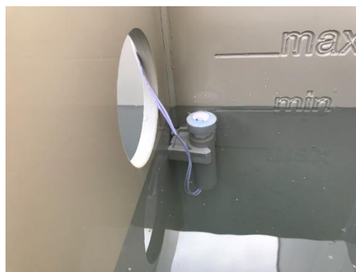
Fig: 2: Vlotter staat in 'spoel' stand, vijverpomp staat aan. Trommel draait en spoelpomp spoelt het doek schoon. Indien de vlotter in deze positie blijft gedurende 30 seconden zal de elektronica in DROOGLOOPMODUS vervallen.
