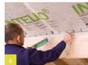
4 Aansluiting op hout
