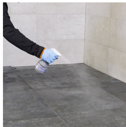
Voor de laatste wasbeurt wordt na ca. 60 minuten PCI Durapox Finish (vloeibaar) op het oppervlak gesproeid.
