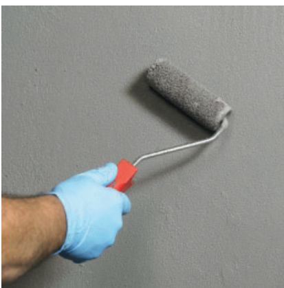
Eerste laag door middel van rollen of kwasten met volledige dekking aanbrengen.
