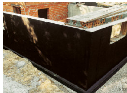
Afdichting van constructies onder het maaiveld tegen bodemvocht en niet drukkend water.
