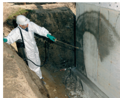
Afdichting zonder luchtballen met bitumenafdichtingslagen op betonnen kelderwanden na grondering met PCI Pecimor-Betongrund.
