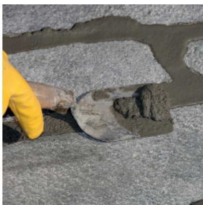
Na het aantrekken van de mortel (vingertoppentest) overtollig materiaal met een troffel weghalen.
