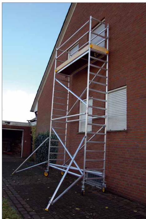
Befindet sich das Gerüst direkt an der Hauswand, reichen zwei Stützen zur Sicherung aus
