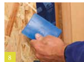
8 Dagkant rondom verlijmen met TESCON VANA
