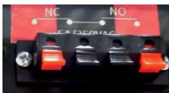
Conexión de alarma remota
