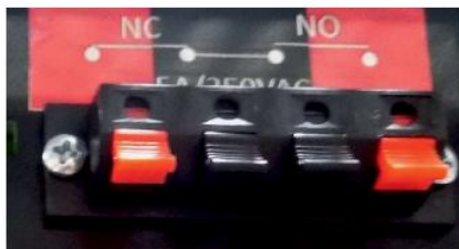
Collegamento allarme remoto
