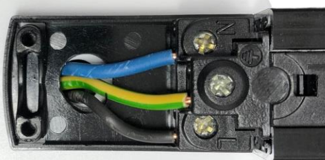
Eindvoeding met kabelinvoer aan plafondzijde
